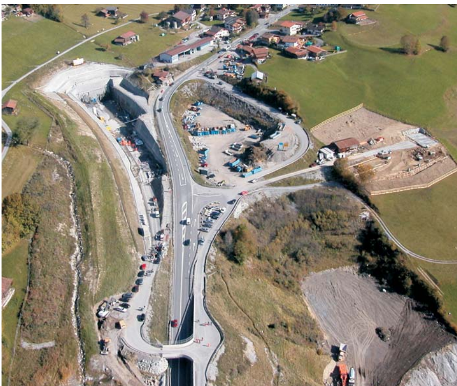
Portalbereich West mit dem grossen Voreinschnitt und rechts im Bild der Installationsplatz des Tunnelunternehmers
